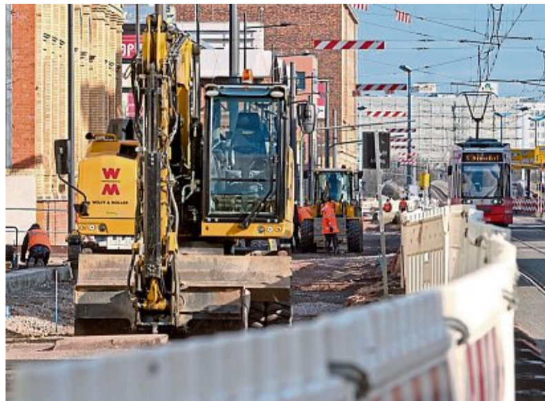
Die Baustelle der Havag in der Merseburger Straße läuft weiter - unter verschärften Hygienevorschriften, die laut Stadtwerke auch kontrolliert werden.
